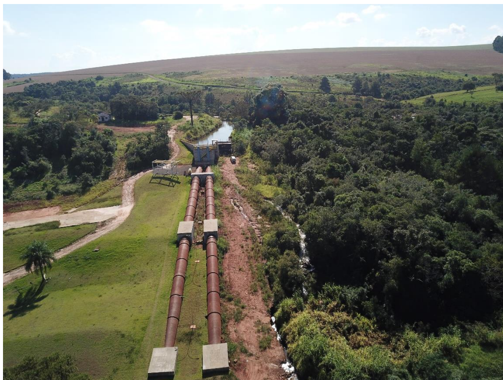
Figura 3.3: Vista dos condutos forçados do empreendimento. Fonte: Construnível, 2023.
